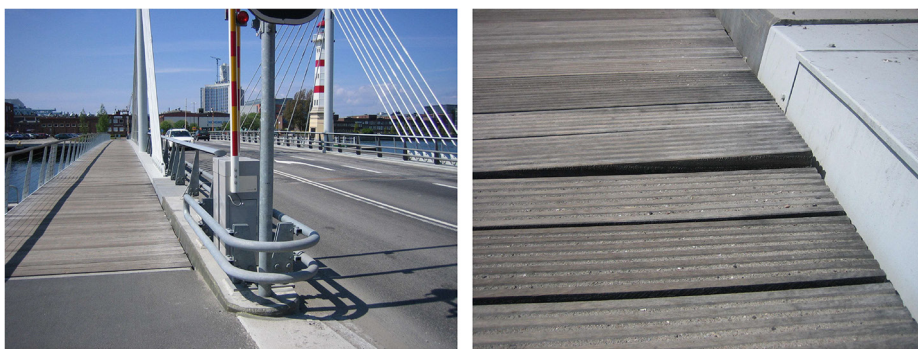
Figur 8: Försämring av träplankorna på trottoaren på universitetsbron.
