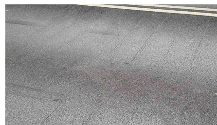
Figur 4: Slitage på ytan och tvärsprickor i det ortotropiska ståldäcket.
